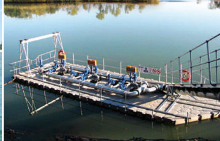
PLATAFORMAS PARA COLECTORES DE BOMBAS DE AGUA
